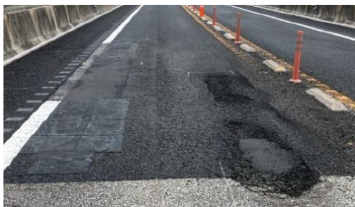
路面損傷状況
