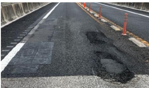
路面損傷状況
