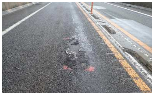
舗装損傷状況
