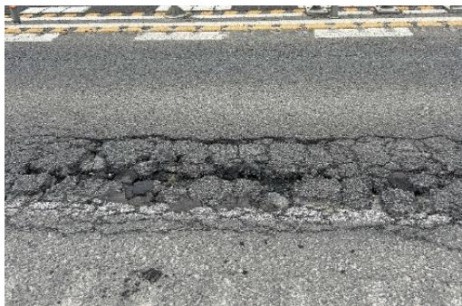
舗装損傷写真
