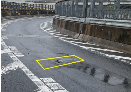
路面損傷状況
