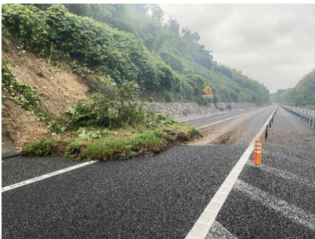
のり面の土砂流出状況
