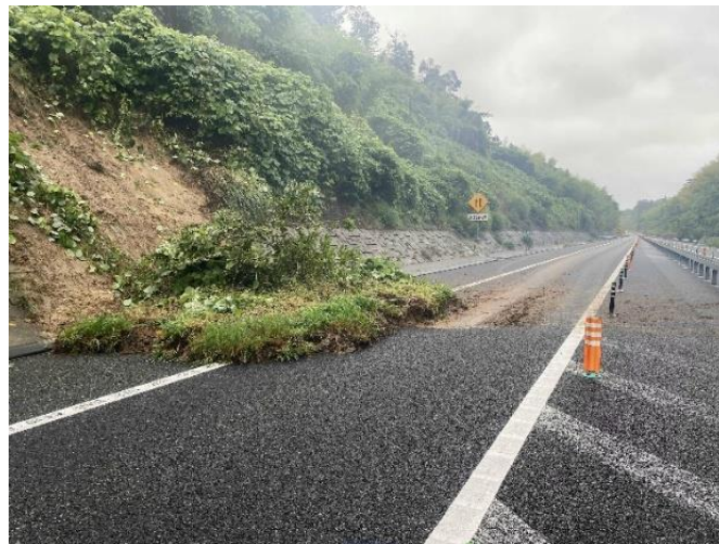
のり面の土砂流出状況
