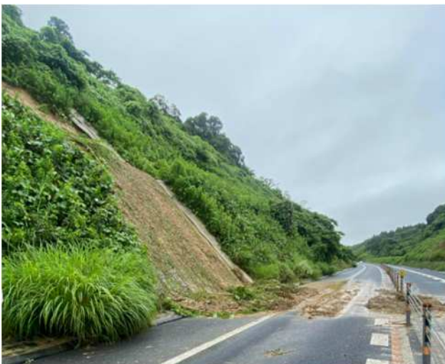
のり面の土砂流出状況
