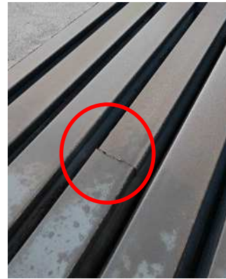
伸縮装置補修工事 損傷状況(近景)
