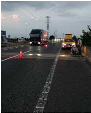
伸縮装置補修工事 損傷調査状況
