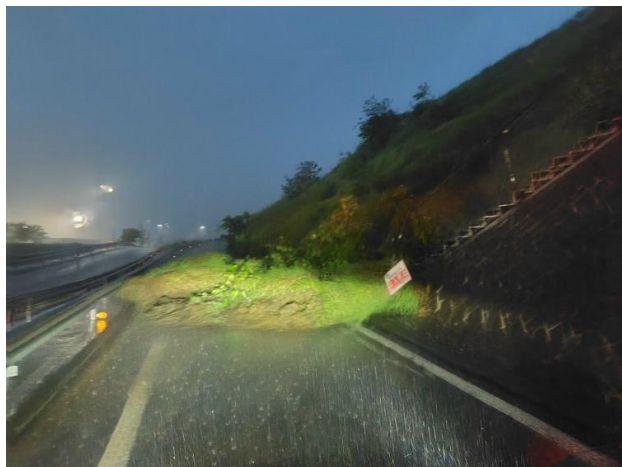
のり面土砂流出状況(太田強戸スマートIC)
