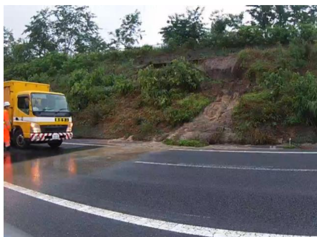
のり面土砂流出状況(足利IC～佐野田沼IC)
