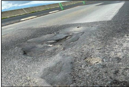
舗装損傷写真
