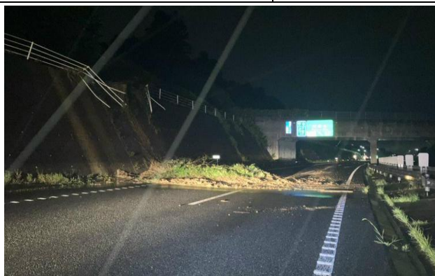
首都圏中央連絡自動車道 （茂原長南 IC～茂原北 IC）の被災状況
