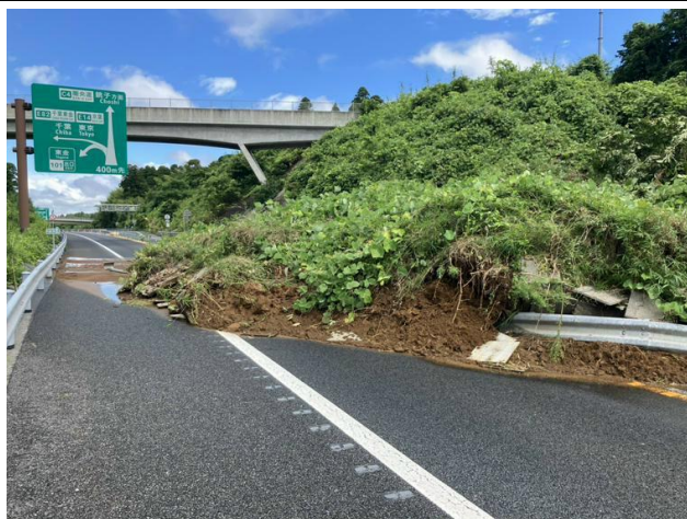
C4 首都圏中央連絡自動車道（圏央道） （東金 IC～大網白里スマート IC）の被災状況
