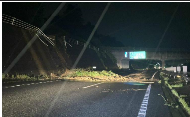
首都圏中央連絡自動車道 （茂原長南 IC～茂原北 IC）の被災状況
