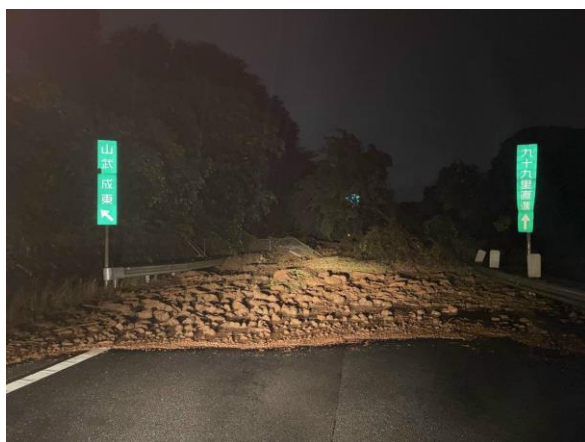
千葉東金道路の被災状況
