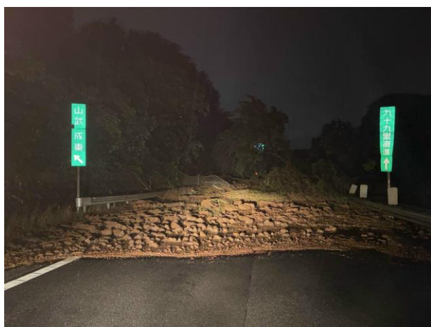
千葉東金道路の被災状況
