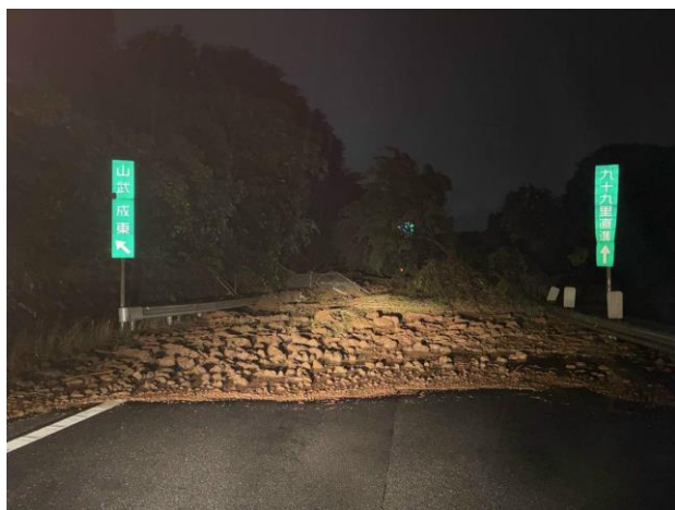
千葉東金道路の被災状況
