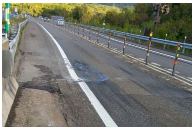
段差の発生状況
