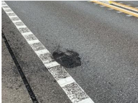
路面損傷状況
