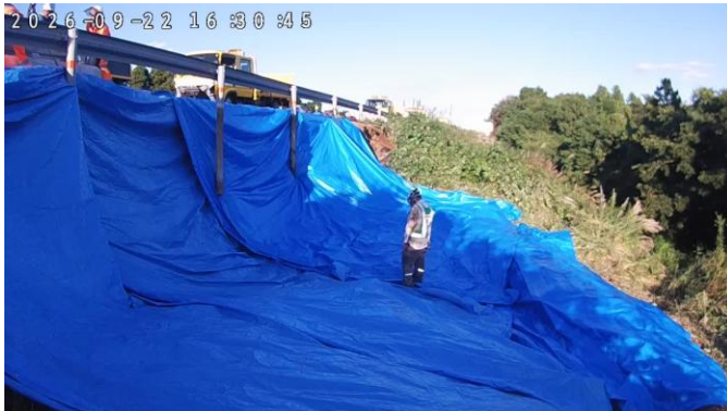
被災状況写真
