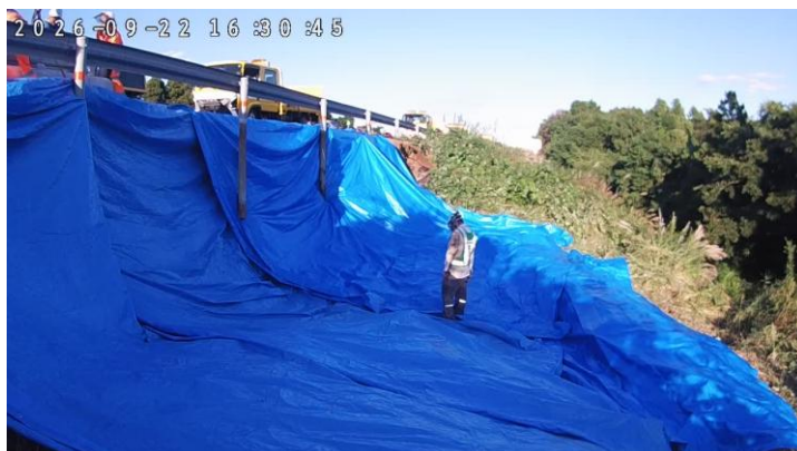
被災状況写真
