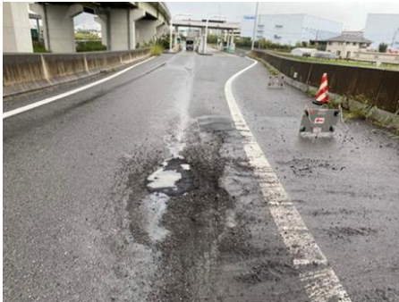
路面損傷状況
