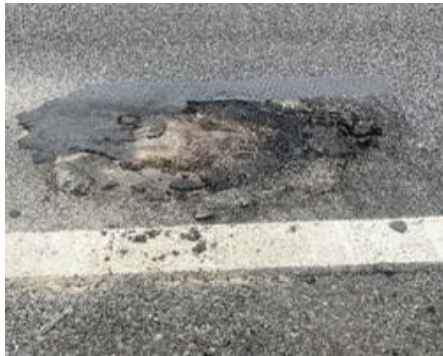
舗装損傷状況
