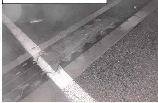
写真2（破損状況写真）
