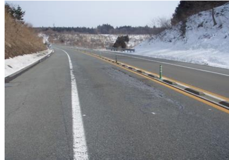
【路面損傷状況】
