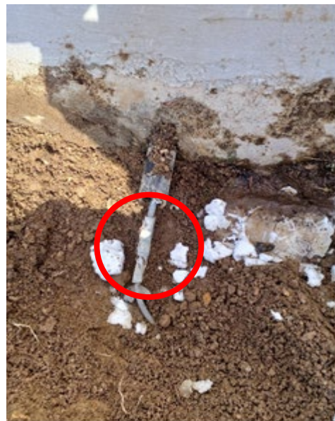
(配管破損状況)
