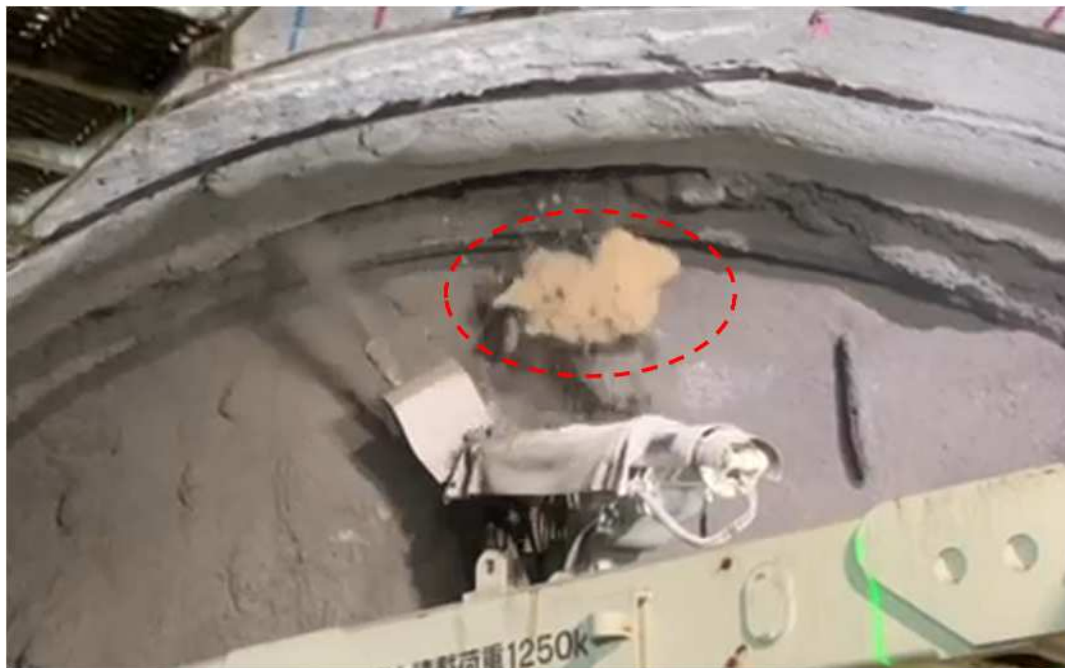
吹付け時の地山とコンクリートの抜け落ち状況
