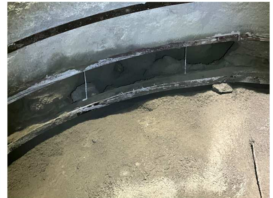
抜け落ちた後の状況
