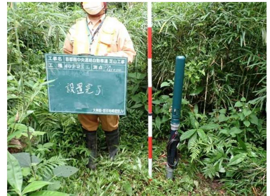
〔観測井戸・水位計設置状況〕
