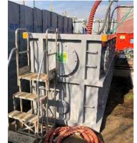
水タンク 水貯留
