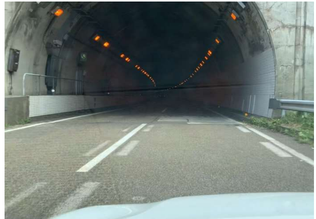
ロードヒーティング埋設箇所
