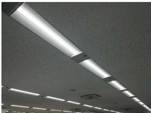
照明LEDによる消費電力の削減
