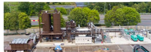
バイオマスガス化発電プラント
