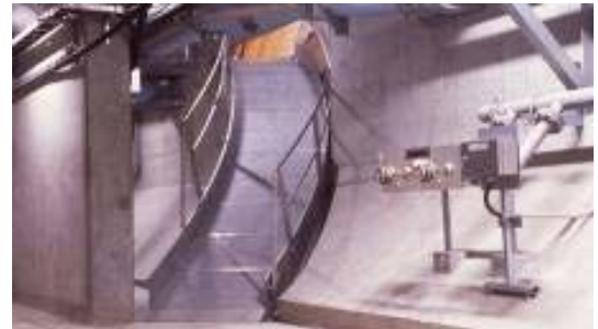
避難経路は車が一台走行できる幅があり、300メートルごとにスロープと非常電話を設置しています
