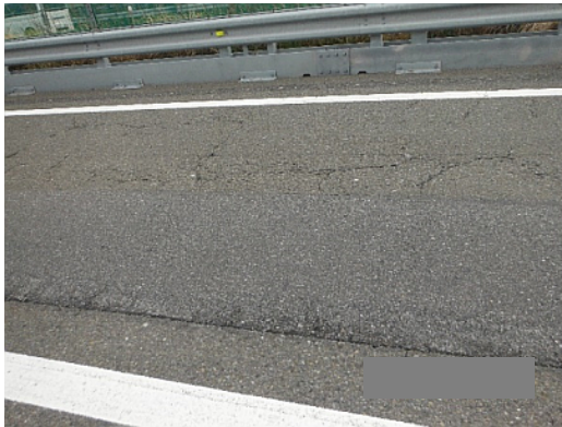
舗装損傷状況
