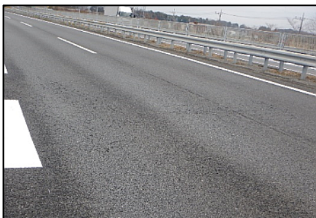
舗装損傷状況
