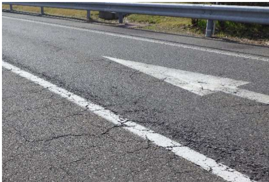
路面の損傷状況(新潟中央JCT～安田IC間)
