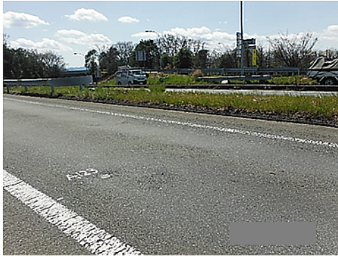
舗装損傷状況
