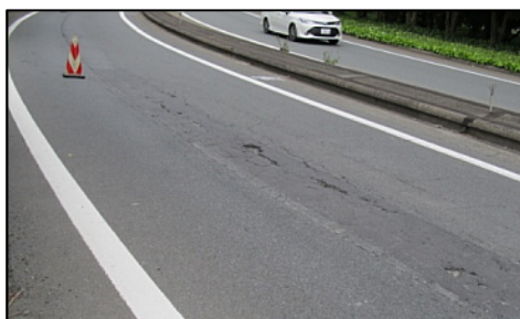
舗装損傷状況
