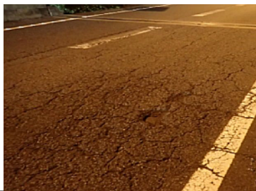
舗装損傷 現況
