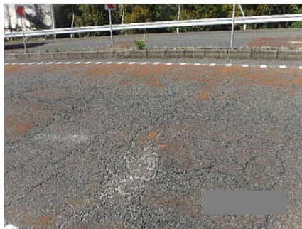
舗装損傷状況
