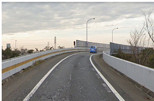
舗装損傷状況
