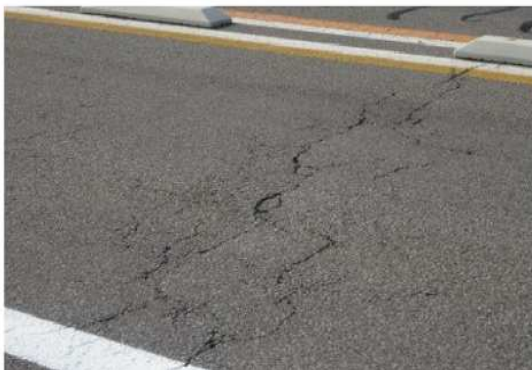
【路面損傷状況】
