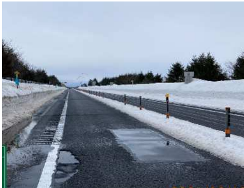
【路面損傷状況】
