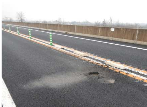
舗装損傷状況
