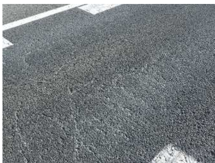
舗装損傷状況
