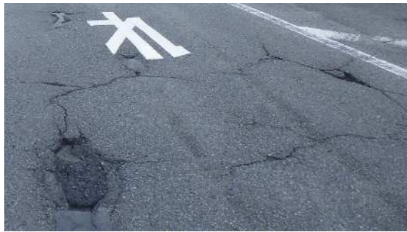
舗装損傷状況
