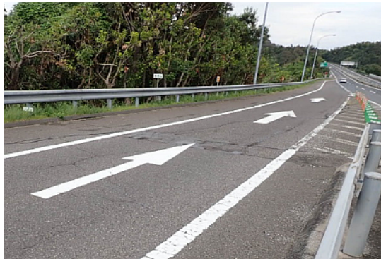
舗装損傷状況
