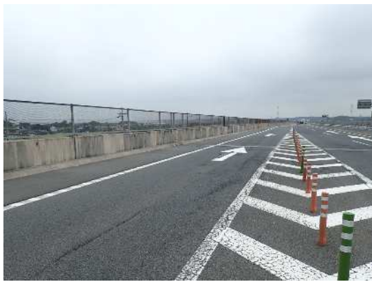
舗装損傷状況
