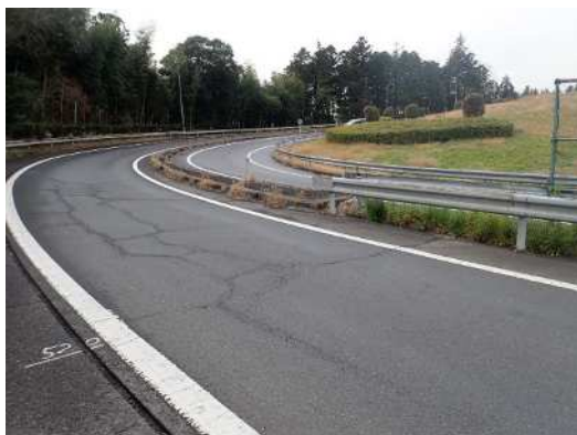
舗装損傷状況
