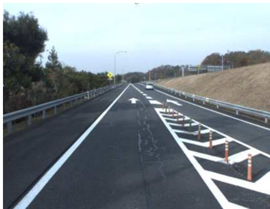
舗装損傷状況
