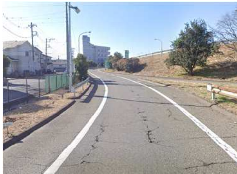
舗装損傷状況
